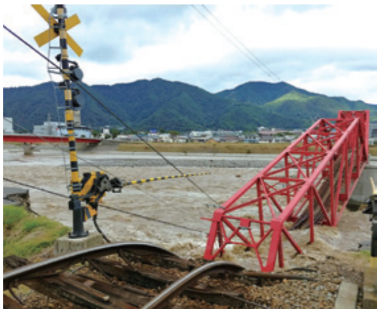
2019（令和1）年10月、台風19号による豪雨の影響で、長野県を流れる千曲川が増水し、鉄橋が崩落した。
