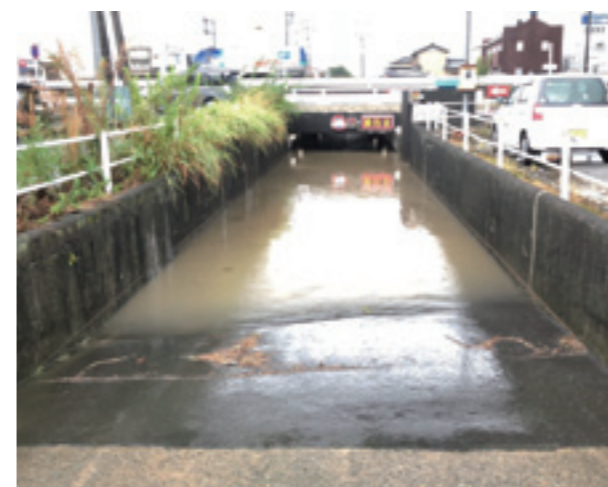
2020（令和2）年の7月豪雨（→シリーズ② p11）によって冠水した、愛知県一宮市のアンダーパス。
