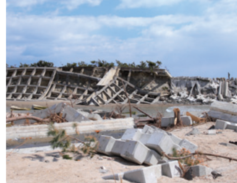
地震・津波によって破壊された、宮城県山元海岸の堤防。
